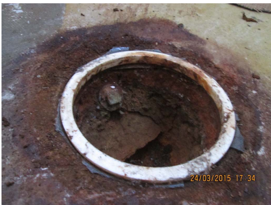
Bild 5 Rost på brunnfläns
