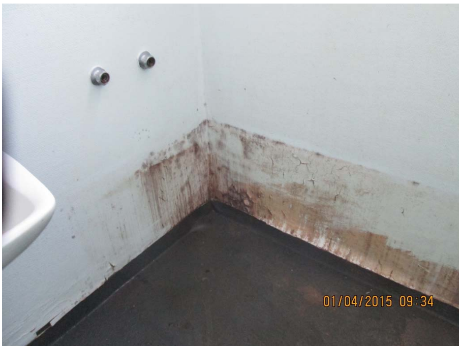
Bild 7 Fuktskada och mikrobiell skada bakom badkar
