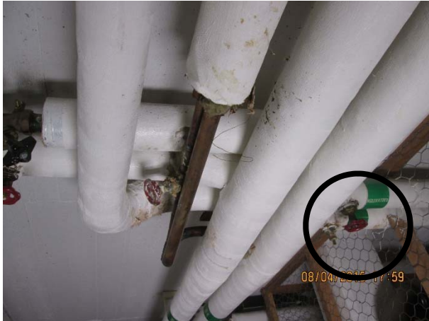
Bild 151 Avstängningsventiler på matningsledning
