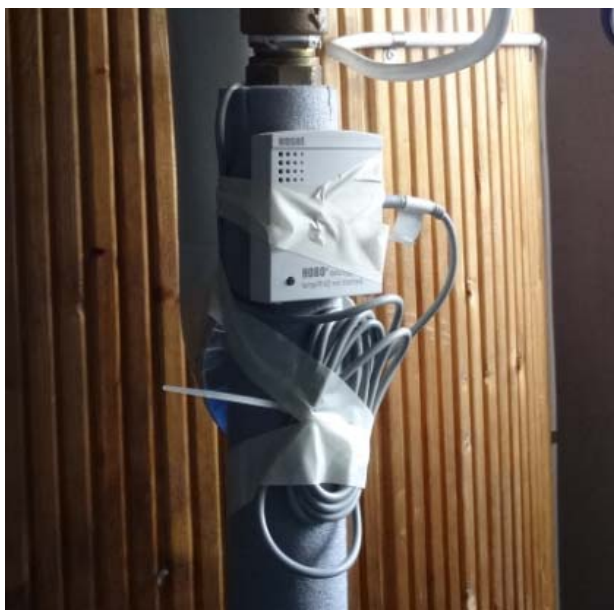
Bild 155 Mätsensor på VVC-rör i Undercentral.
