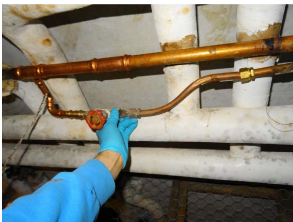
Bild 154 Slutet på slingan i källaren under trapphus A.
