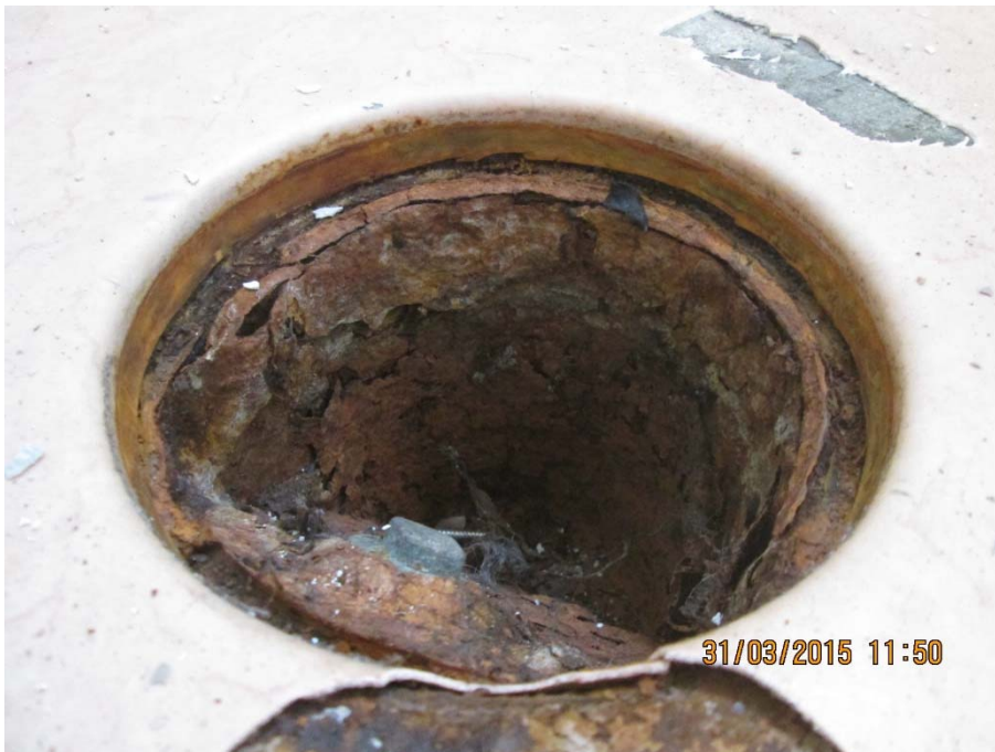
Bild 10 Rostad brunnsfläns vilket orsakat mattsläpp
