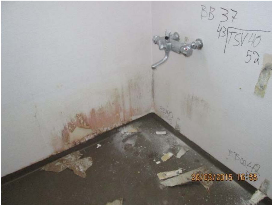
Bild 6 Fuktskada bakom badkar
