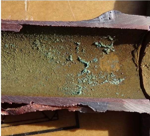
Bild 109 Korrosion i rör vid lödning
