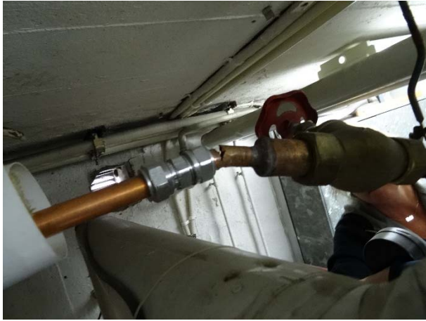
Bild 106 Rörbrott vid demontering
